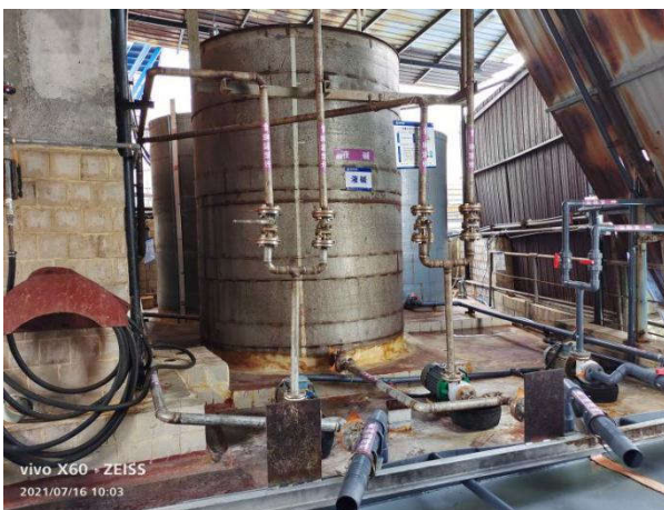
污水处理一站盐罐区
