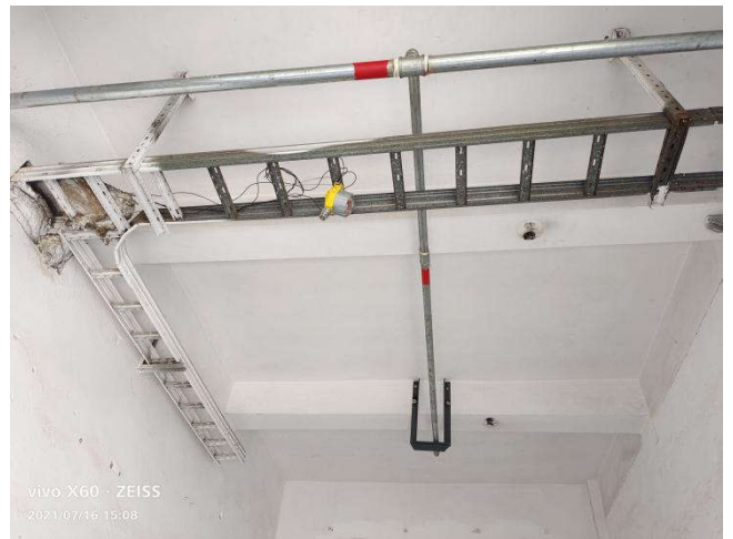
乙炔瓶储存间探测器
