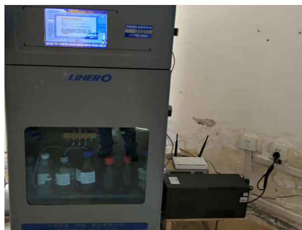
污水处理一站总排口在线监测系统
