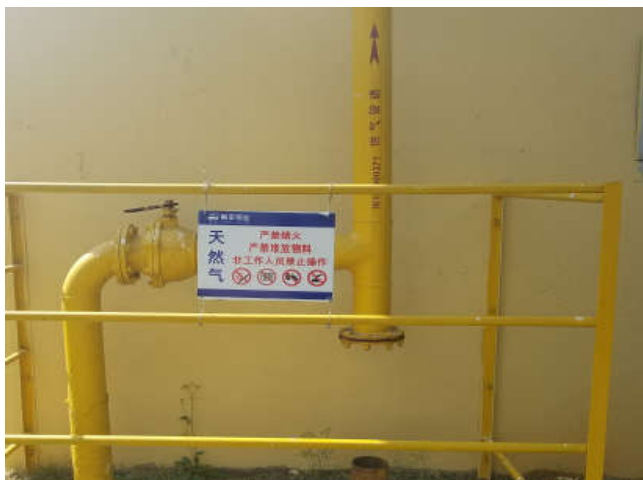
天然气管道及警示标志
