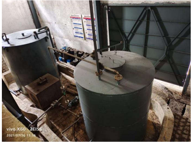
污水处理二站硫酸罐和液碱罐
