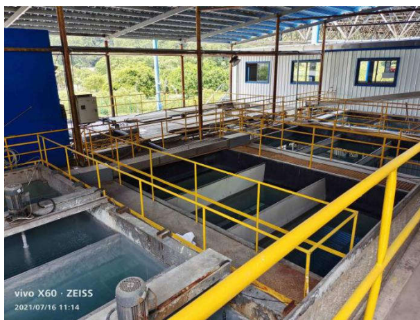
污水处理二站处理池
