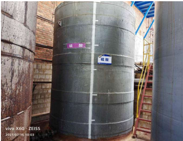
污水处理一站硫酸罐
