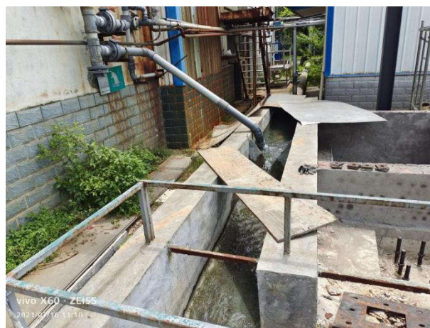
污水处理二站排放口
