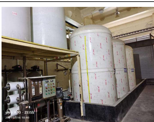
华银氧化车间液碱罐
