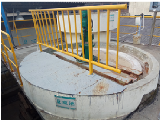
华银污水处理站反应池
