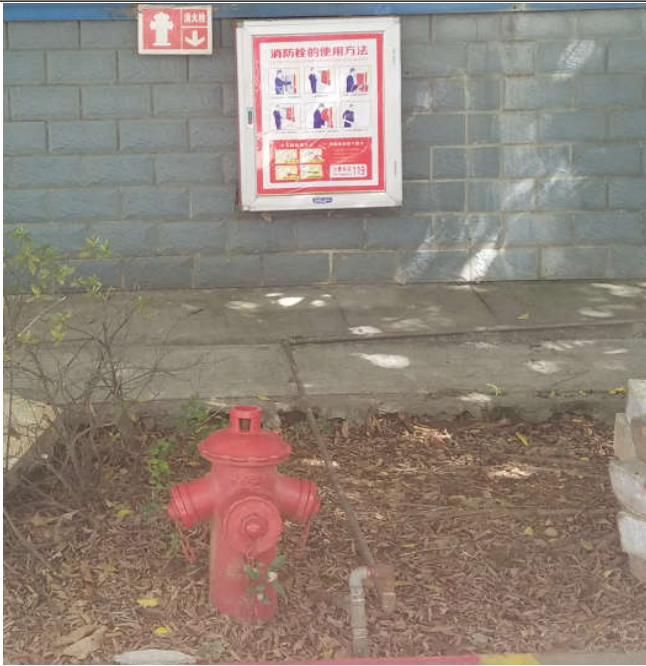
安全生产应急救援设施（消防器材）
