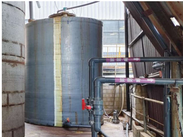
污水处理一站液碱罐
