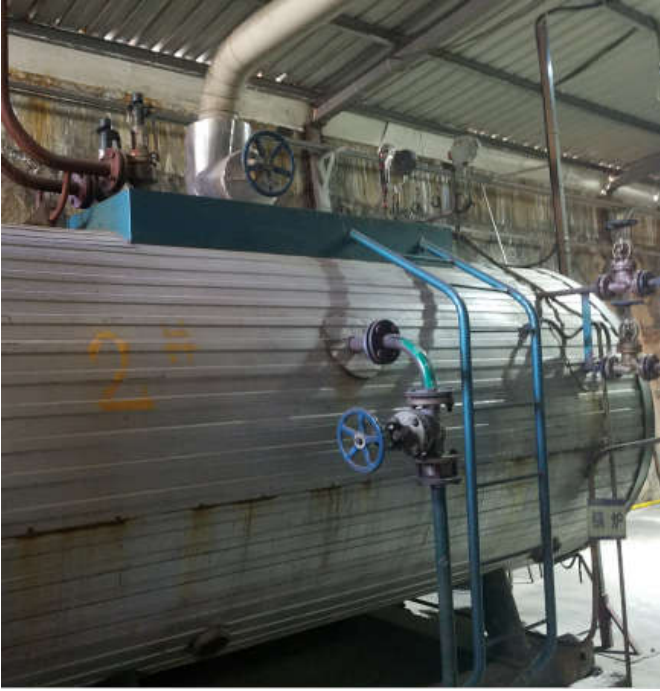
锅炉及仪表监控
