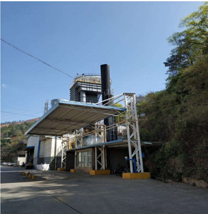
废铝渣处理及废气处理设施
