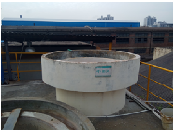
华银污水处理站中和池
