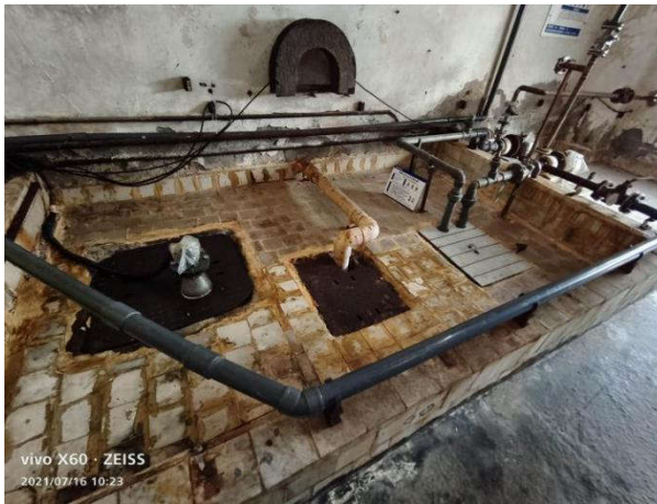
南铝氧化二车间地下碱液罐
