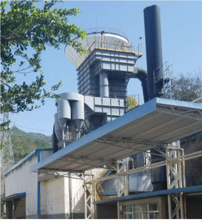
铝渣废气除尘系统
