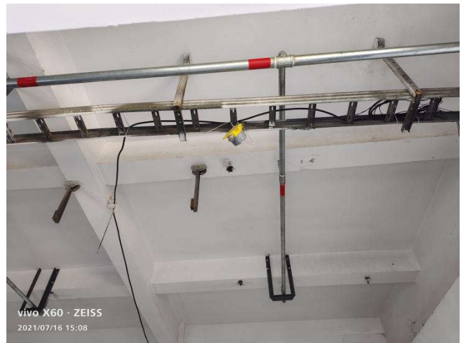
氧气瓶储存间探测器
