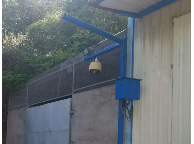
厂区视频监控
