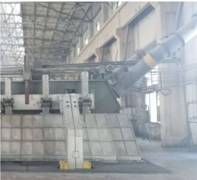
电解生产线排气管
