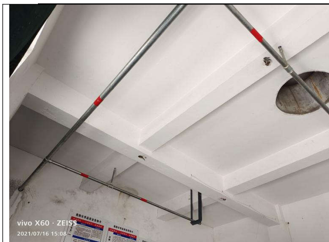
液氨瓶储存间喷淋设施
