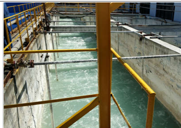
污水处理一站调节池
