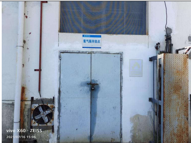
氧气瓶储存间
