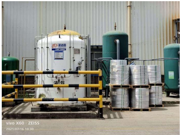
华银厂区氩气储罐
