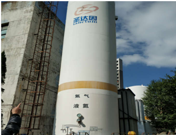
化工库北侧液氮储罐
