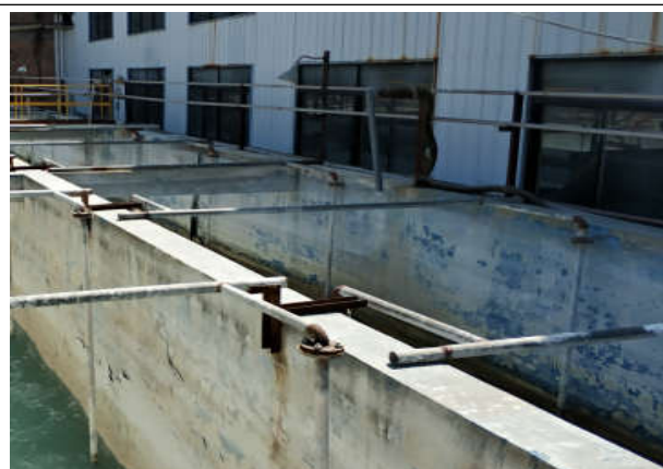
污水处理一站事故应急池（270m 3 污水处理池）
